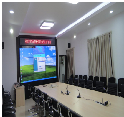
节能监管平台监控大厅
